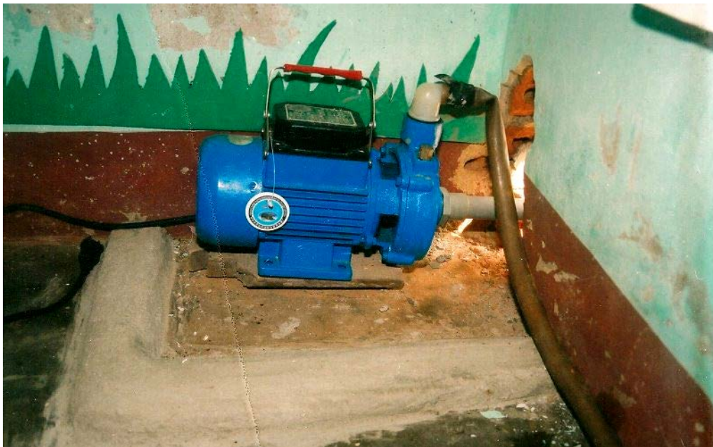
Hình 3. Máy bơm nước
