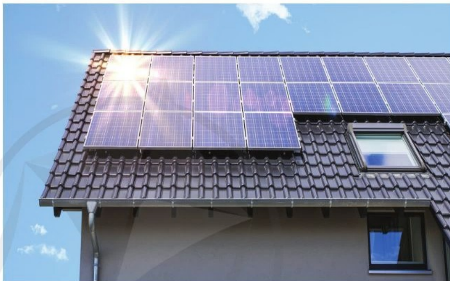
Hình 3.5. Hệ thống pin mặt trời trên mái nhà
